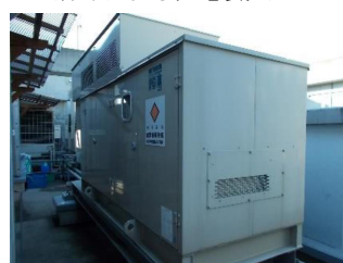
(非常用自家発電装置)
